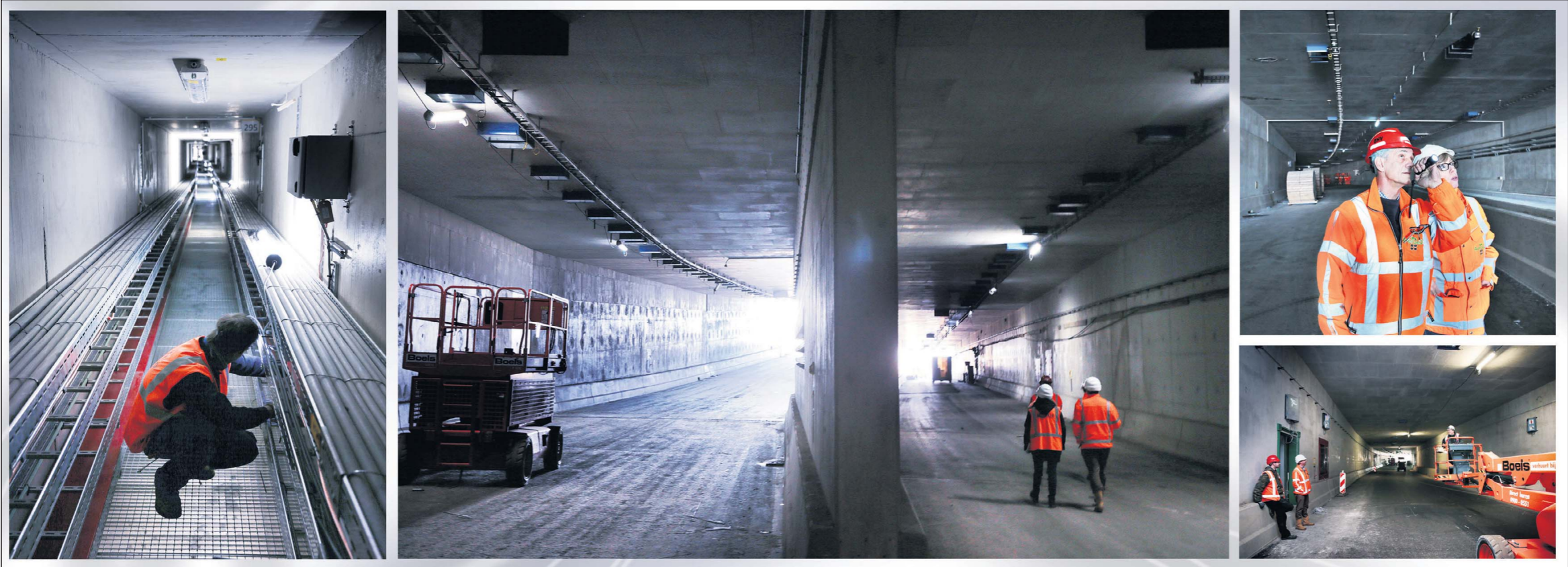
- Links: de aanleg van kabels in het middentunnelkanaal. - Midden: het einde van de bovenste tunnelbuizen bij de Geusselt. - Rechtsboven: Wim Toonen en woordvoerder Desiree Florie bekijken de systemen die aangebracht zijn in de tunnel. - Beneden: Medewerkers van Avenue2 ronden de werkzaamheden in de tunnel deze weken af.
