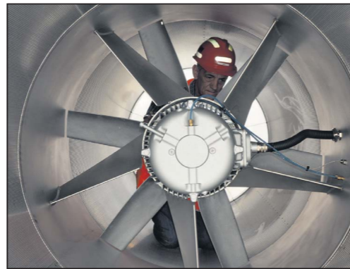
Wim Toonen inspecteert een van de ventilatoren die in de tunnel hangen.
