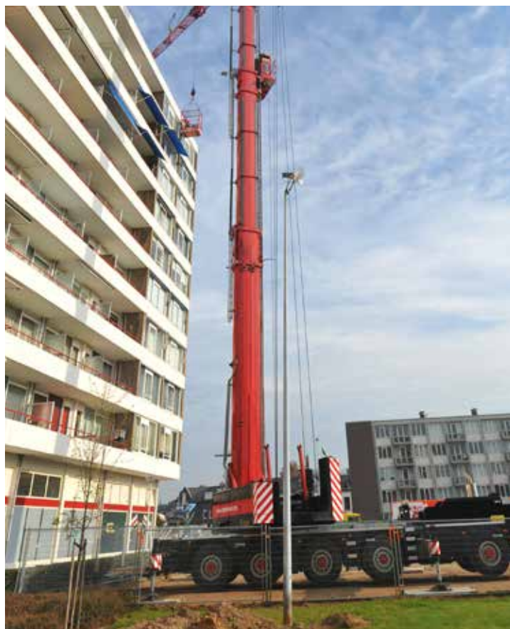
Aan de gevel van de ANWB-flat worden voor aanvang van de tunnelbouw meetinstrumenten bevestigd (2011).
