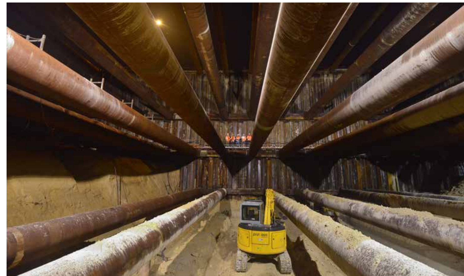
Over het hele tracé ligt de tunnel zo'n 17 meter diep. Behalve bij Geusselt, waar tunnelmoot 85 ligt: met 22 meter is dit het diepste punt van de tunnel (2012).
